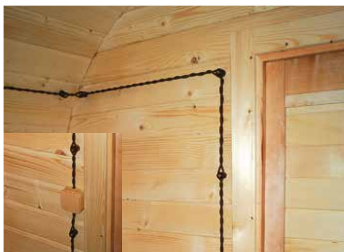
Vintage- Retroverkabelung mit Keramikhaltern
