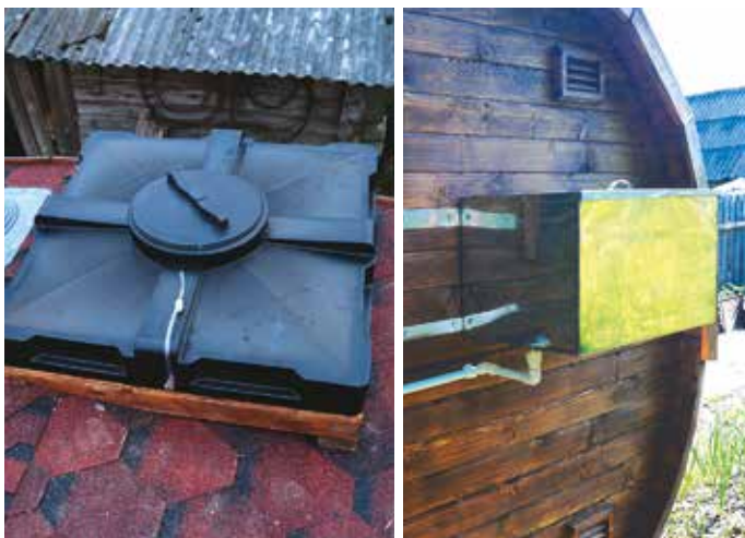
Tank für die Sommerdusche / Tank für die Kaltwasserversorgung der Sauna
